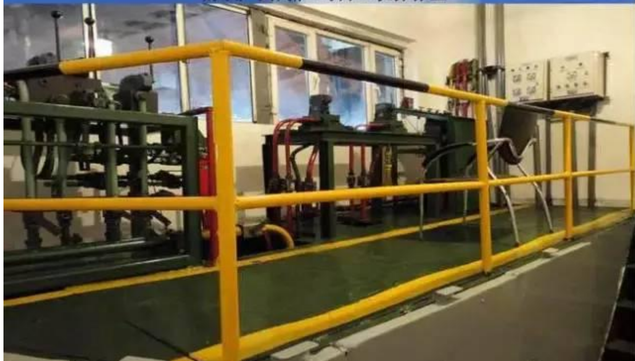
炼铁厂四高炉4号开口机操作室
