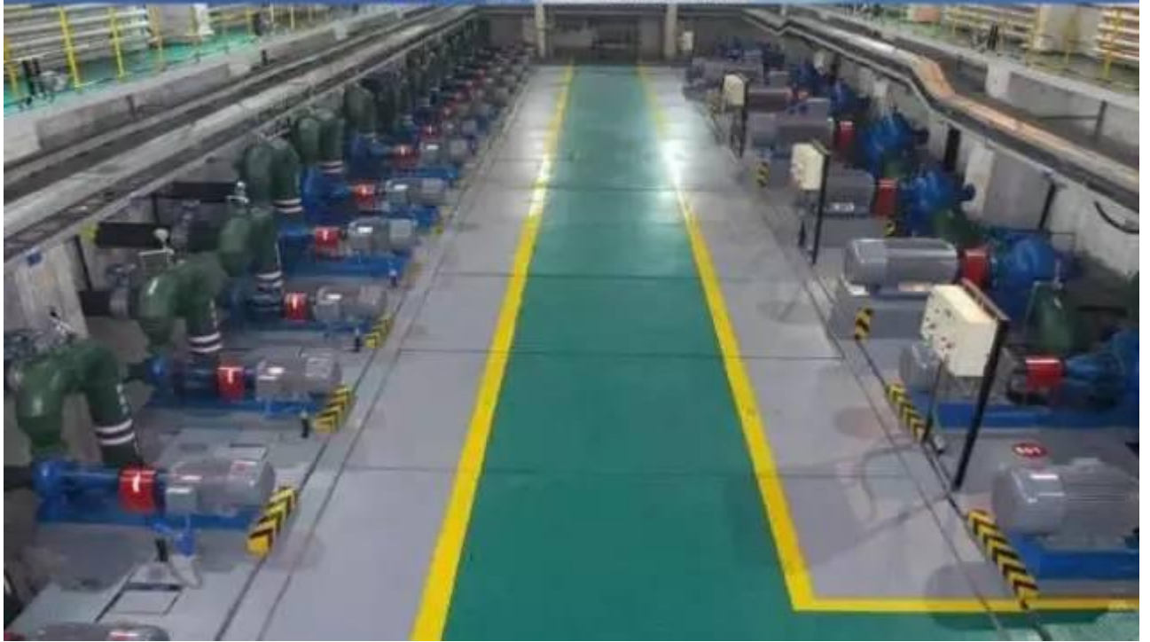
给水厂五车间4号综合泵站
